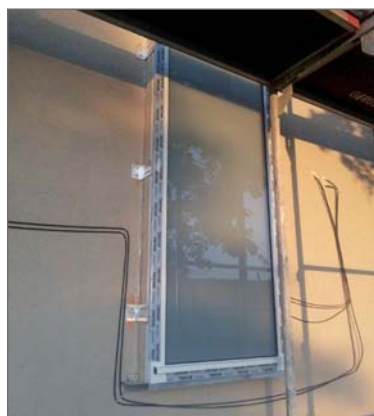
Solarer Luftkollektor mit Haltewinkeln an der Fassade befestigt, mit Kabel für Temperaturfühler und Stromversorgung für die Ventilatoren
